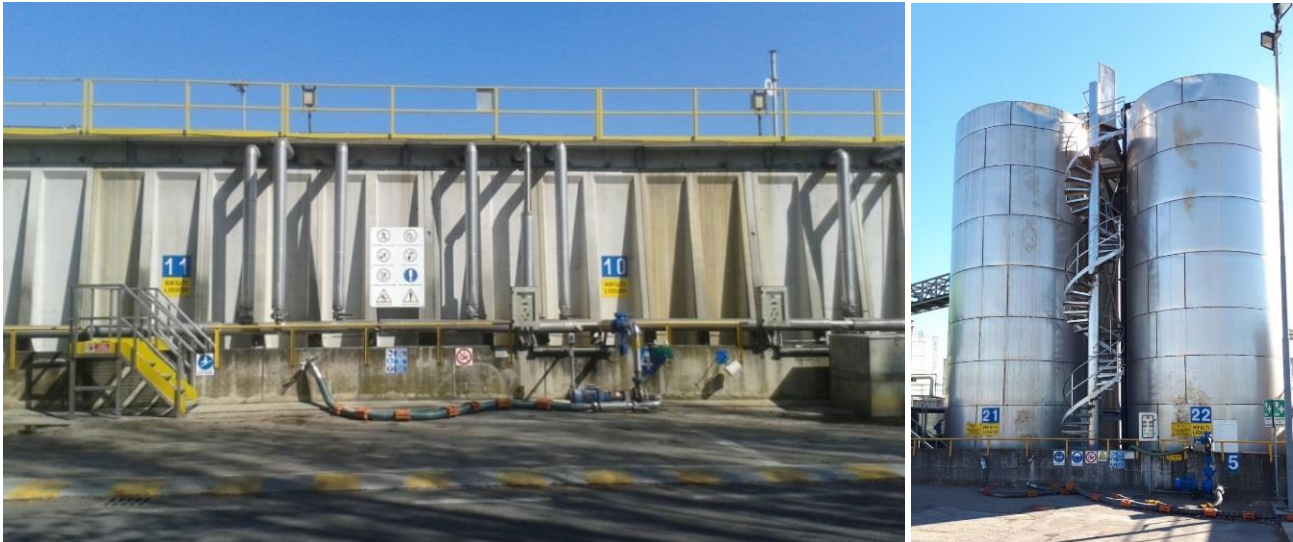
Figura 7 Vasche di stoccaggio dei percolati e serbatoi in acciaio
