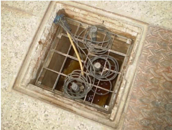
Figura 9 Pozzetto di campionamento
